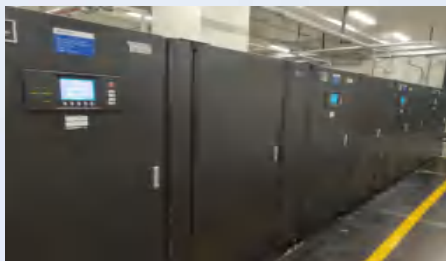
中国银行北京、内蒙数据中心
