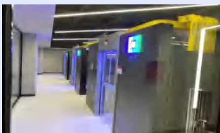
阳光保险通州数据中心
