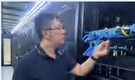
中广核大悟数据中心
