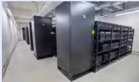
中体彩亦庄数据中心
